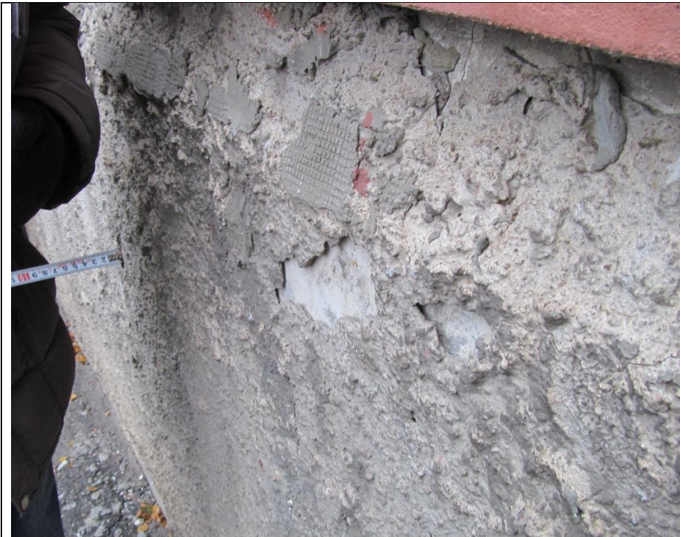
Відшарування облицювання цоколю.
