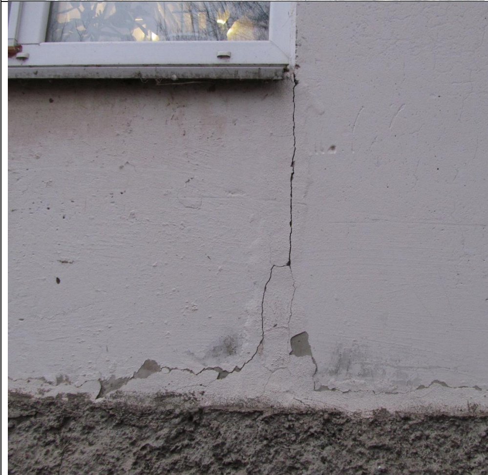
Тріщина на фасаді.
