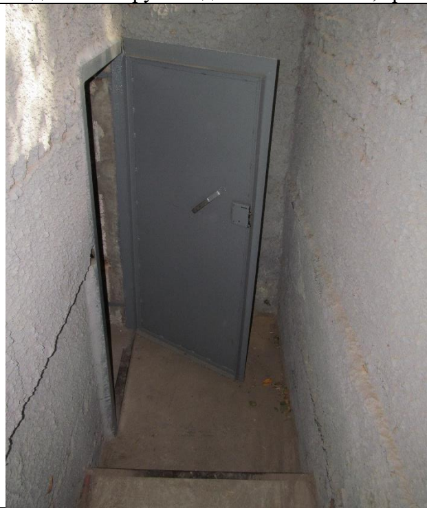
Вхід до підвалу. Тріщина між фундаментними блоками та цоколем
