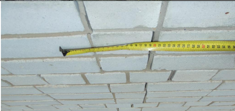
Температурна тріщина та вивітрювання розчину на фасаді будівлі.
