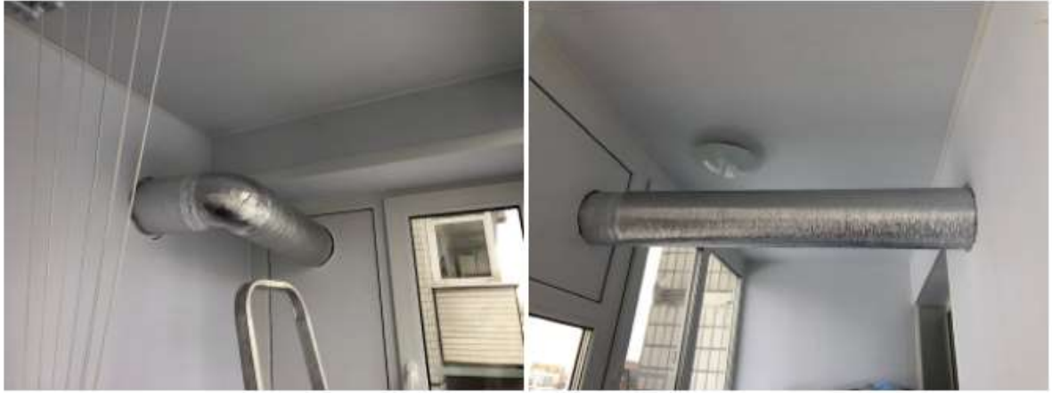
Світлина 6. Приклад влаштування повітропроводів при встановленні рекупераційної установки в приміщенні
