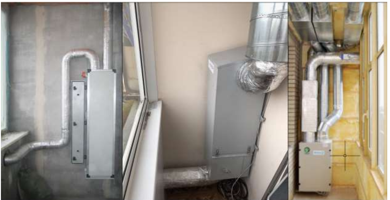
Світлина 7. приклад влаштування повітропроводів при встановленні рекупераційної установки в приміщенні
